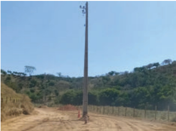
Com os cortes, postes estão ficando no meio da pista
