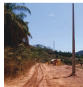
Mais postes em local perigoso
