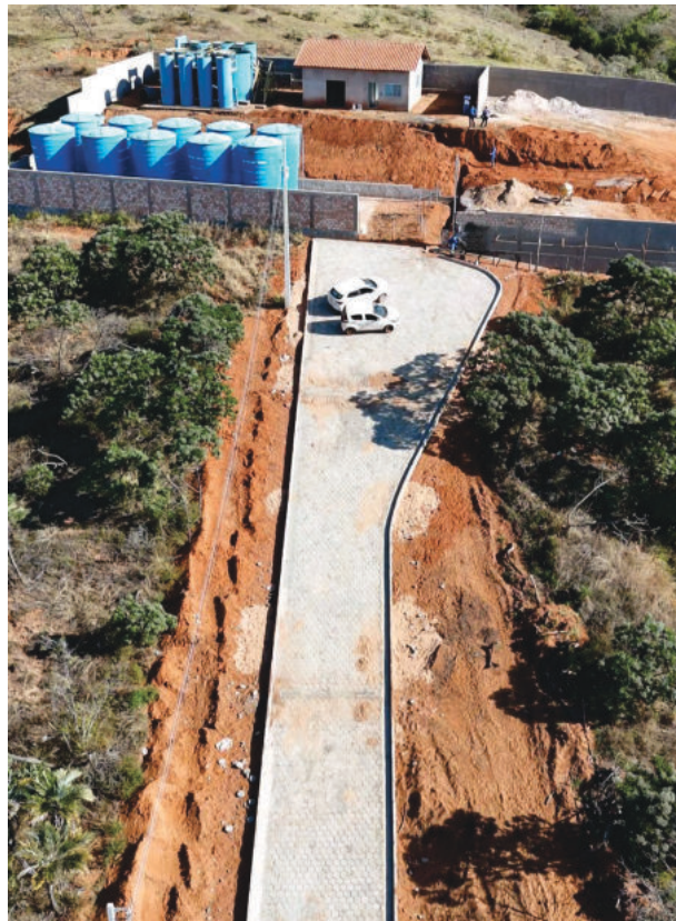
O reservatório conta com 10 unidades de 30 mil litros cada, totalizando uma oferta de 300m³ de água potável, que chegará aos consumidores por gravidade
