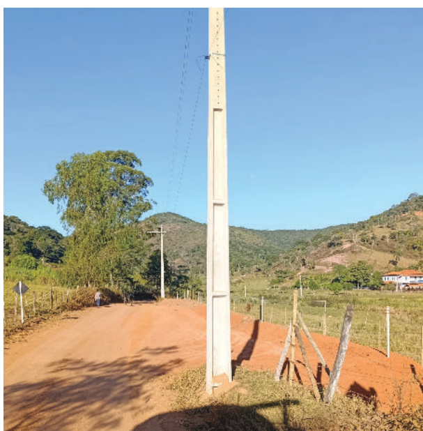
Postes de iluminação instalados em pontos perigosos denunciam a falta de planejamento
