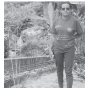
Geralda ao lado do muro que caiu antes mesmo de ser concluído
