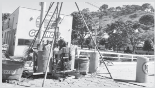
No dia 20 de abril empresa realizou sondagem para definir melhor fundação para a obra
