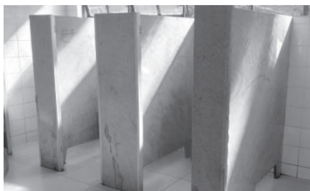
Banheiros não têm portas e torneiras do lavabo não funcionam
